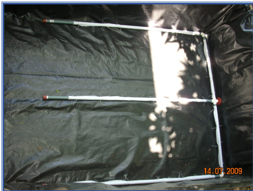
Figura 7 Tuberías para el sistema de recolección de lixiviados
