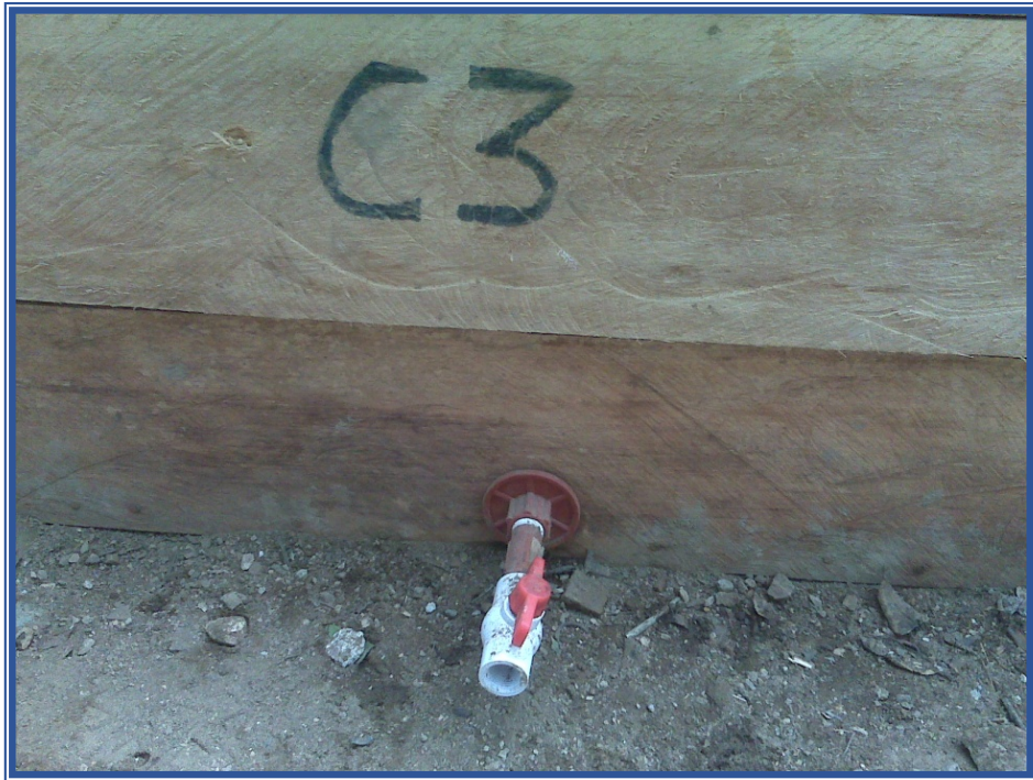
Figura 8 Llaves para la salida de lixiviados
